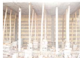
شکل ۸- عدم اتصال مناسب بین بلوک و آجر در اجرای دیوار
