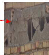
تیرچه بلوک فاقد شناز افقی
