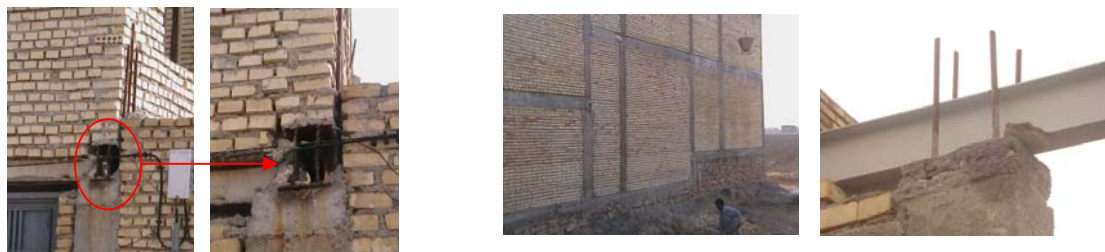
شکل ۹- عدم کلاف بندی مناسب افقی وقائم در ساختمان های بنایی
