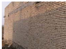
شکل ۴- ساختمان بامصالح بنایی که فقط شناز افقی بالایی در آن ها اجرا شده است.
